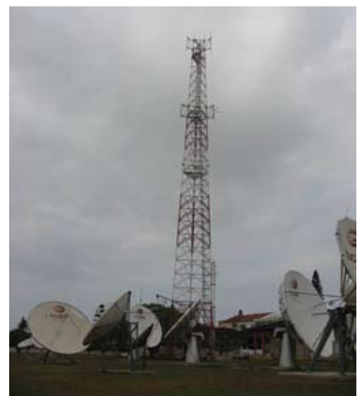
Antena de transmisión en la estación base en Maputo, capital de Mozambique.
