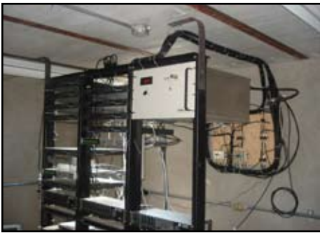
Transmisor instalado en Monte Escobedo, Zacatecas, México
