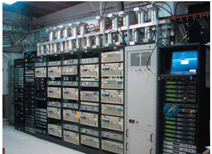
Cabecera de Univisa en Guayaquil con el nuevo transmisor digital MMDS (centro) al lado del transmisor canalizado analógico anterior
