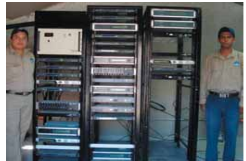
Erick Rodríguez y José Hernández de TV ZAC durante la instalación del transmisor de MMDS en Río Grande.
