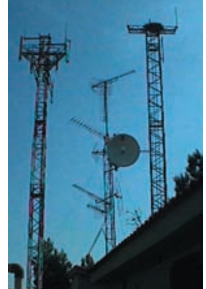
Headend 1.2 meter Antenna.
